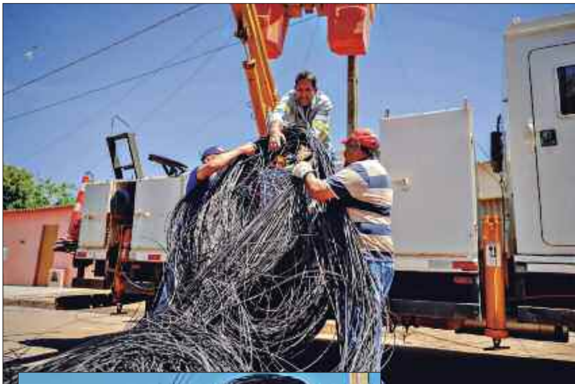
Fios expostos em Anápolis
